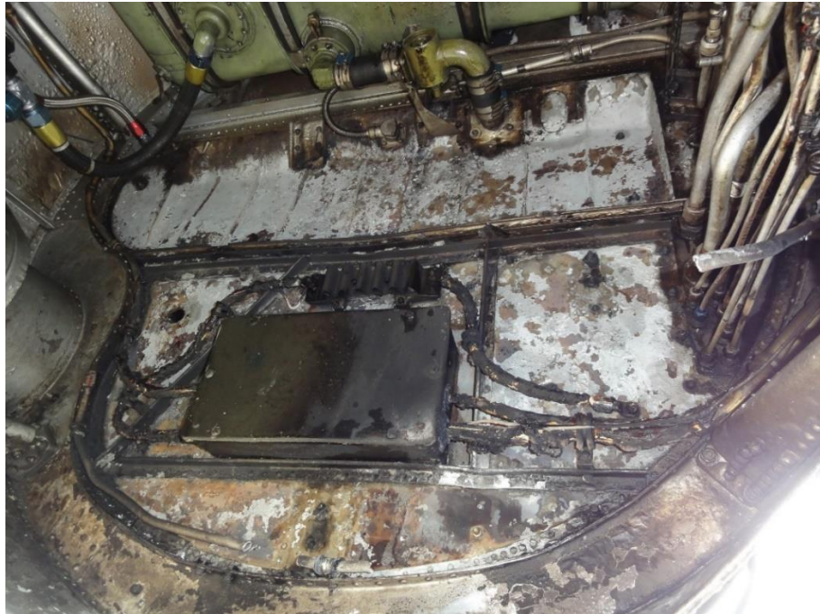
Figur 9. Brandskador i zon 3. Bland annat har kablar på brandväggen mot apparatrummet smält och brunnit.
