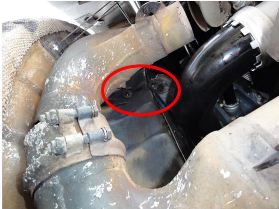
Figur 6. Ett av de tre fästen där skruvförbanden saknades mellan avgassamlaren och motorn.
